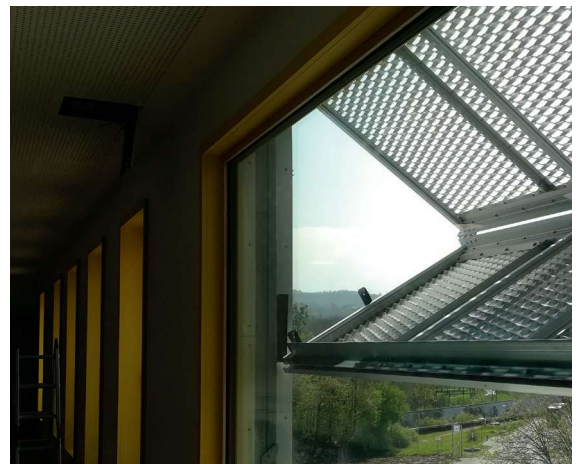
Innenansicht einer Fassadenanlage.
